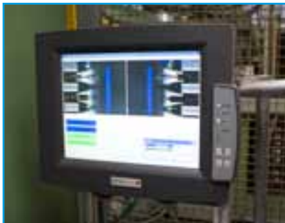
Schweißnahtüberwachung durch Laserabtastung
