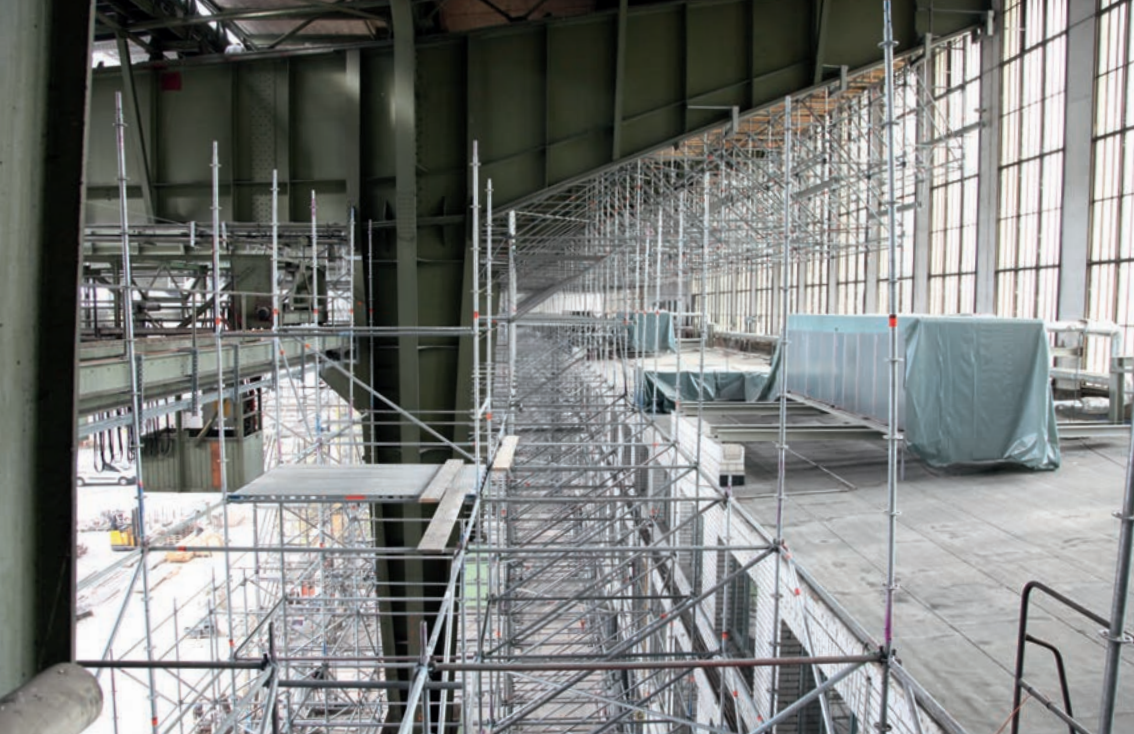
Das Traggerüst vor den innenliegenden Gebäudeteilen wurde mit dem Layher AllroundGerüst realisiert und trägt den vorderen Teil der Arbeitsplattformen unter dem Dach.
