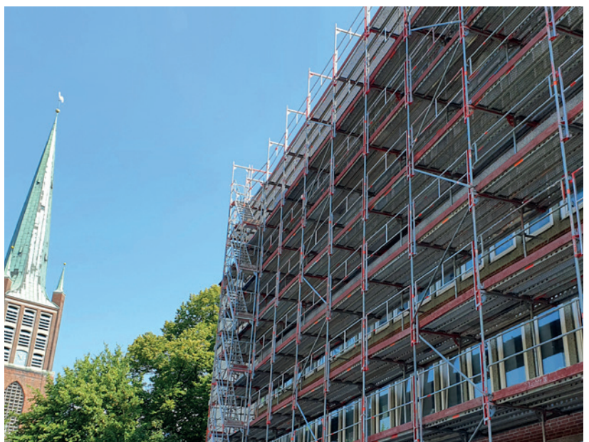
Fassadengerüst an Bürogebäude mit Podesttreppenaufstieg und I-Geländer
